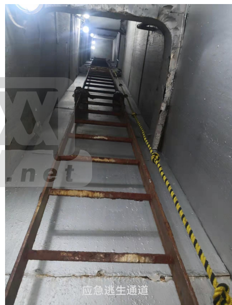
机舱应急脱险通道
