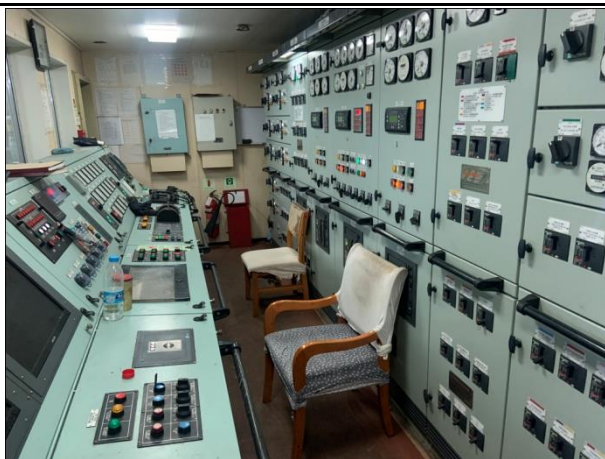
集控室配电屏
