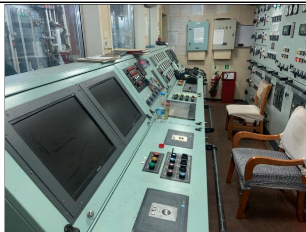
集控室操控台
